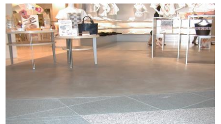
店舗 床劣化防止
