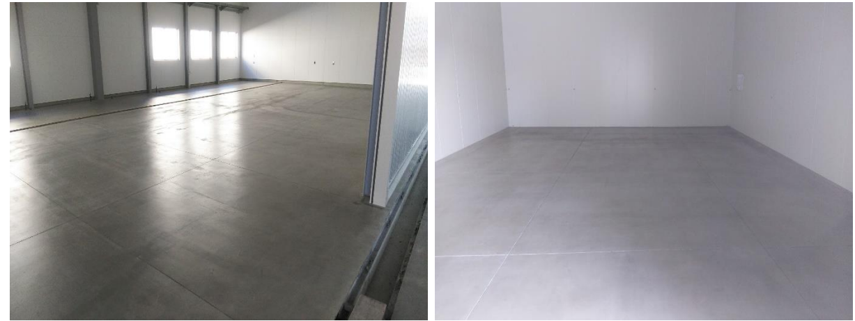
■工事名:喜々津製菓選果場新築工事 ■施工年:2017年 ■施工場所:長崎県 ■施工数量:1,100㎡ ■目的:選果場コンクリート床防塵・防汚・衛生(艶ありタイプを使用)
