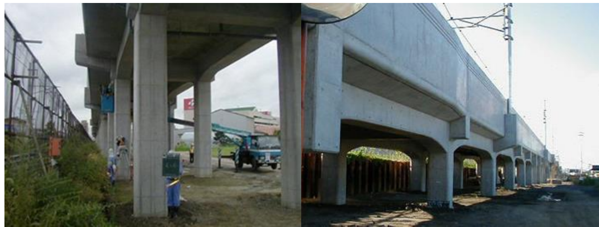
■ 工事名: 大元高架橋南第2工区工事 ■ 施工年: 2001年 ■ 施工場所: 岡山県 ■ 施工数量: 298㎡ ■ 目的: 高架橋スラブ、ピア他劣化対策
