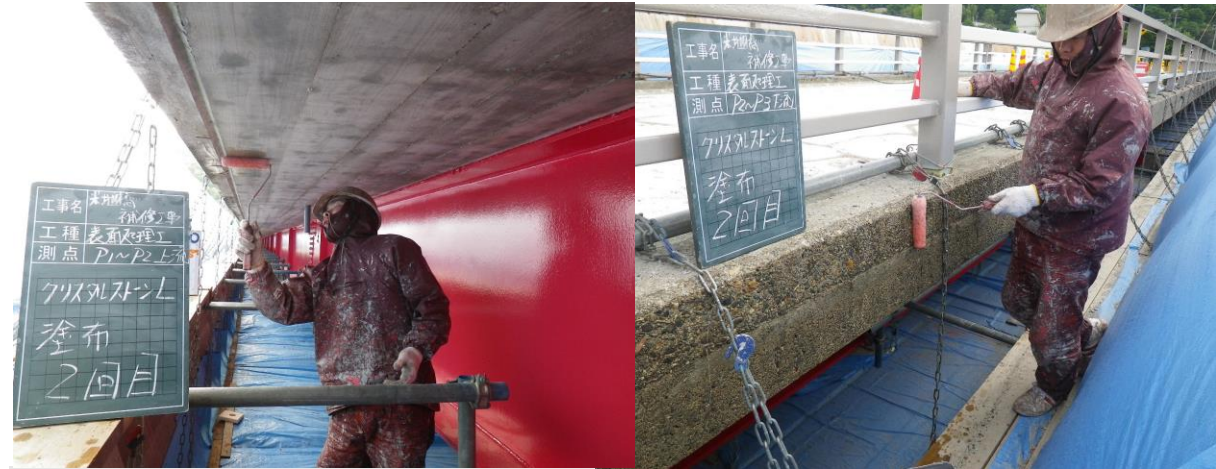
■ 工事名: 米地橋補修工事 ■ 施工年: 2015年 ■ 施工場所: 兵庫県 ■ 施工数量: 100㎡ ■ 目的: コンクリート表面保護
