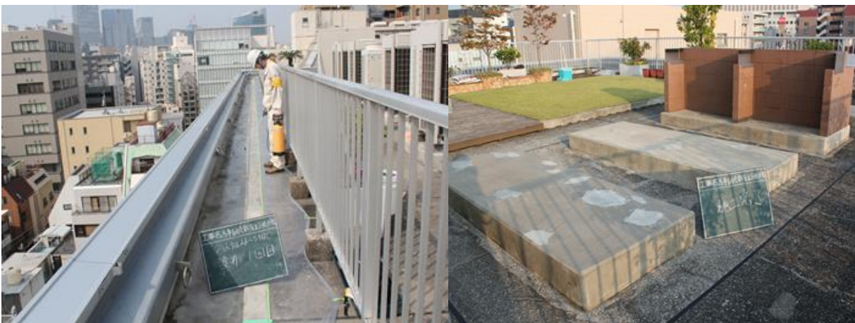
■ 工事名:馬事畜産会館屋上劣化防止工事 ■ 施工年:2011年 ■ 施工場所:東京都 ■ 施工数量:84㎡ ■ 目的:屋上コンクリート補修・劣化対策(USCPモルタル併用)
