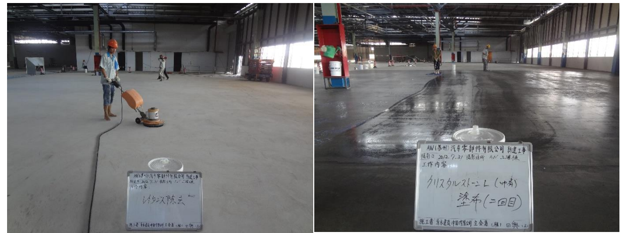
■ 工事名: 自動車部品工場新築工事 ■ 施工年: 2012年 ■ 施工場所: 蘇州(中国) ■ 施工数量: 6,000㎡ ■ 目的: コンクリート床 表面強化 耐油性(艶ありタイプを使用)
