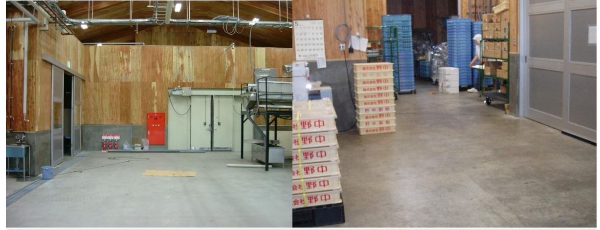
■工事名:(株)野中工場新築工事 ■施工年:2007年 ■施工場所:山梨県 ■施工数量:3,223㎡ ■目的:本社新築工事 土間 基礎、床(艶ありタイプを使用)
