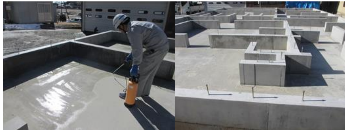
■ 工事名: A様邸新築工事 ■ 施工年: 2018年 ■ 施工場所: 宮城県 ■ 施工数量: 220㎡ ■ 目的: 基礎コンクリート含浸材塗布
