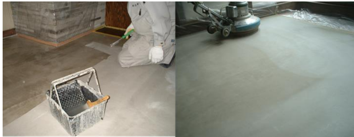
■工事名:溝の口店舗改修工事 ■施工年:2006年 ■施工場所:神奈川県 ■施工数量:20㎡ ■目的:土間コンクリート防塵対策
