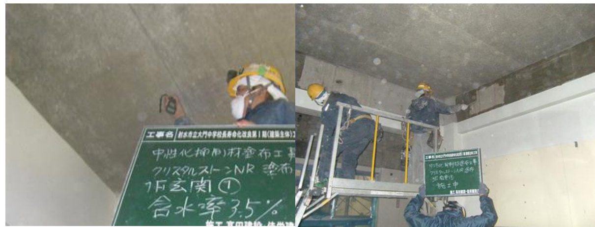
■工事名:射水市大門中学校長寿命化改良第Ⅰ期(建築主体)工事 ■施工年:2019年 ■施工場所:富山県 ■施工数量:3,223㎡ ■目的:校舎棟既設コンクリート躯体(教室・廊下ほか)中性化対策
