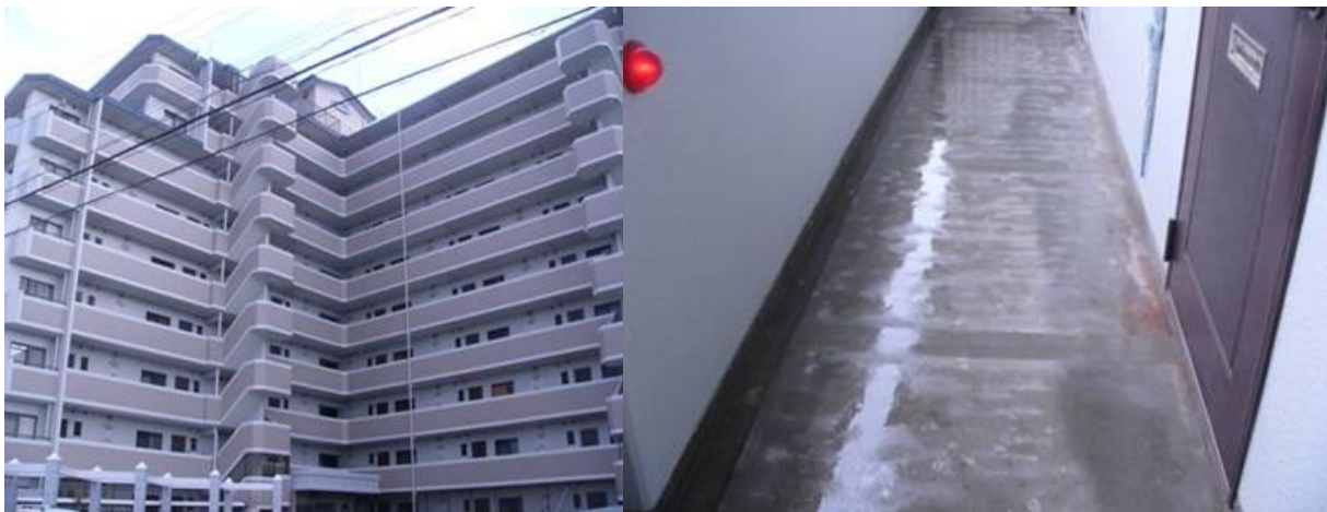
■工事名:アムール和白Ⅲ大規模改修工事 ■施工年:2006年 ■施工場所:福岡県 ■施工数量:不明 ■目的:コンクリート床防塵対策
