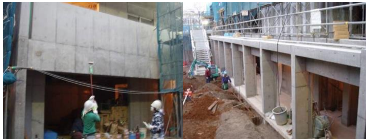
■ 工事名:明治大学国際交流会館新築工事 ■ 施工年:2008年 ■ 施工場所:東京都 ■ 施工数量:1,240㎡ ■ 目的:外壁コンクリート劣化対策
