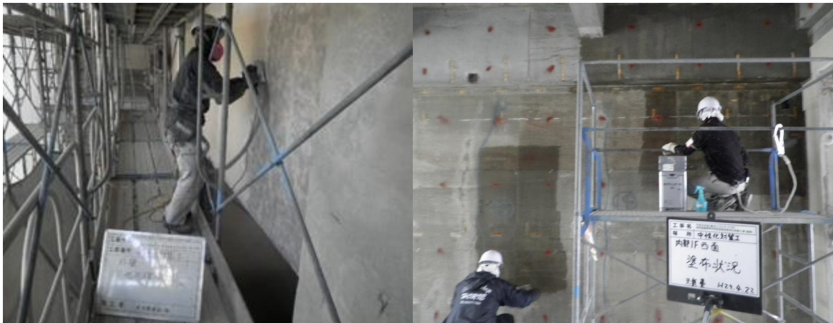
■工事名:長寿命化改修工事(中性化対策)島田商業高校 ■施工年:2017年 ■施工場所:静岡県 ■施工数量:5,138㎡ ■目的:長寿命化(中性化対策)
