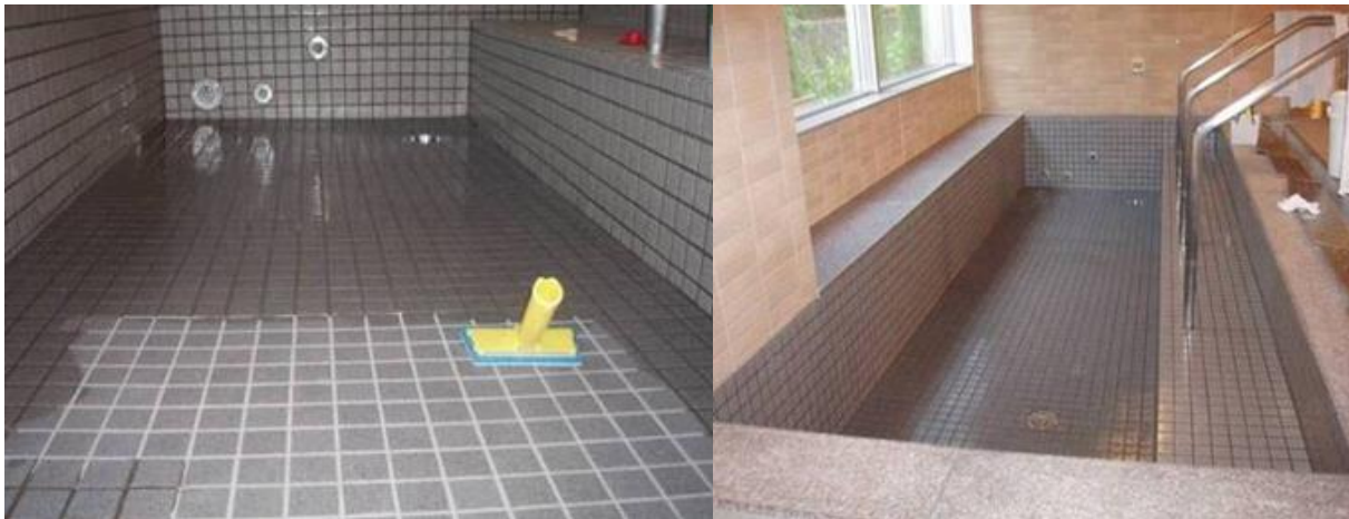
■ 工事名: 寿幸会つつじヶ丘福祉施設浴槽塗装工事 ■ 施工年: 2005年 ■ 施工場所: 愛知県 ■ 施工数量: 20㎡ ■ 目的: モルタル目地劣化対策
