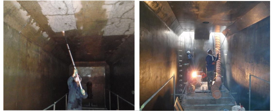
■工事名:千徳第一浄水場PC集水井補修液体ガラス塗装工事 ■施工年:2014年 ■施工場所:岩手県 ■施工数量:200㎡ ■目的:コンクリート表面改質
