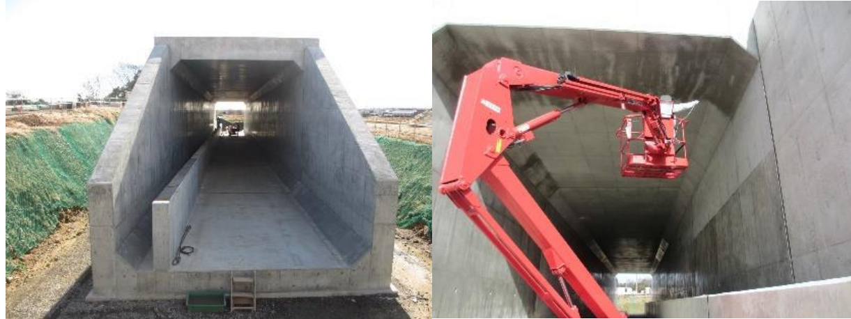
■ 工事名: 新名神高速道路四日市中工事 ■ 施工年: 2014年 ■ 施工場所: 三重県 ■ 施工数量: 9750㎡ ■ 目的: ボックスカルバート内部
