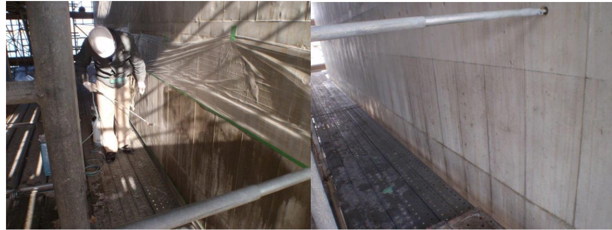
■ 工事名: 大阪港北港南区航路(-16m)附帯施設護岸(3)本体工事 ■ 施工年: 2016年 ■ 施工場所: 大阪府 ■ 施工数量: 508㎡ ■ 目的: 遊水部及びスリットを含むケーソン外周部含浸材塗布
