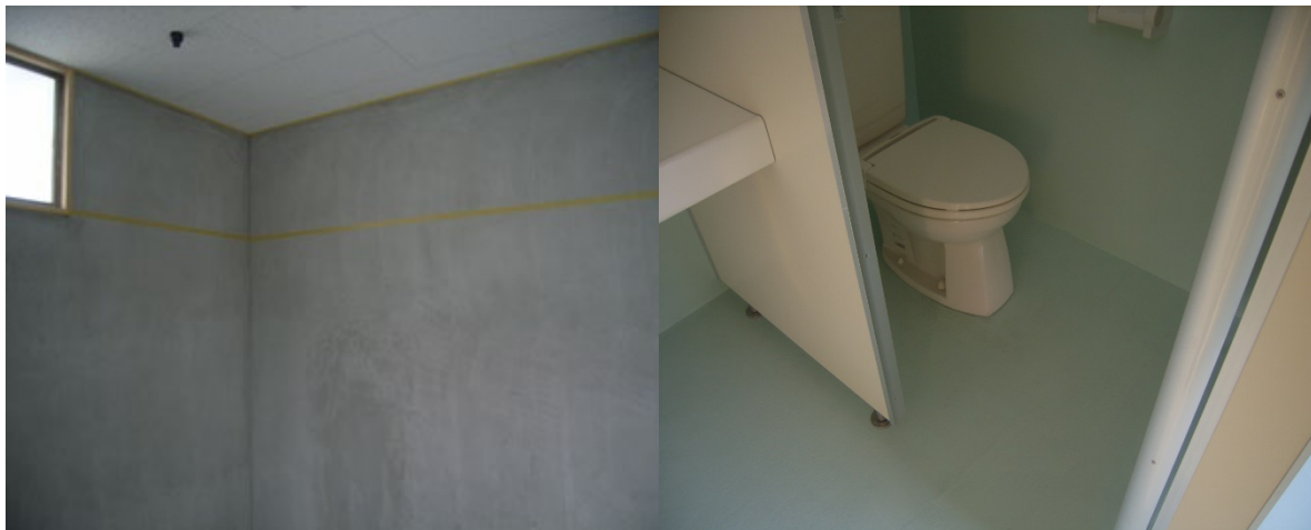
■ 工事名:ガソリンスタンドトイレ改修工事 ■ 施工年:2009年 ■ 施工場所:福島県 ■ 施工数量:40㎡ ■ 目的:トイレ内壁コンクリート着色・調湿・VOC対策
