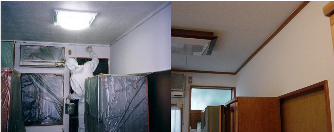
■ 工事名:個人住宅内装塗装工事(八王子) ■ 施工年:2002年 ■ 施工場所:東京都 ■ 施工数量:50㎡ ■ 目的:内装壁紙着色・調湿・VOC対策
