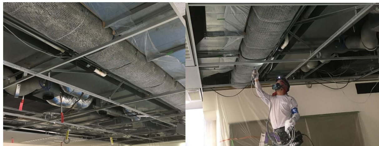
■ 工事名: タワービルオフィス棟天井被覆材固化工事 ■ 施工年: 2017年 ■ 施工場所: 東京都 ■ 施工数量: 300㎡ ■ 目的: 貸し事務所スケルトン化に伴うロックウール固化
