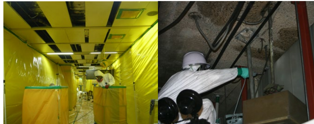
■ 工事名: ソウルメトロ宣陵駅石綿封じ込め工事 ■ 施工年: 2009年 ■ 施工場所: 韓国 ■ 施工数量: 600㎡ ■ 目的: 吹付石綿封じ込め
